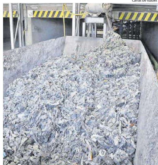
Contenedor con toallitas y residuos en una EDAR.
